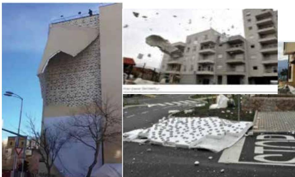
Слика 136 Одвајање фасадне облоге усљед дејства вјетра
