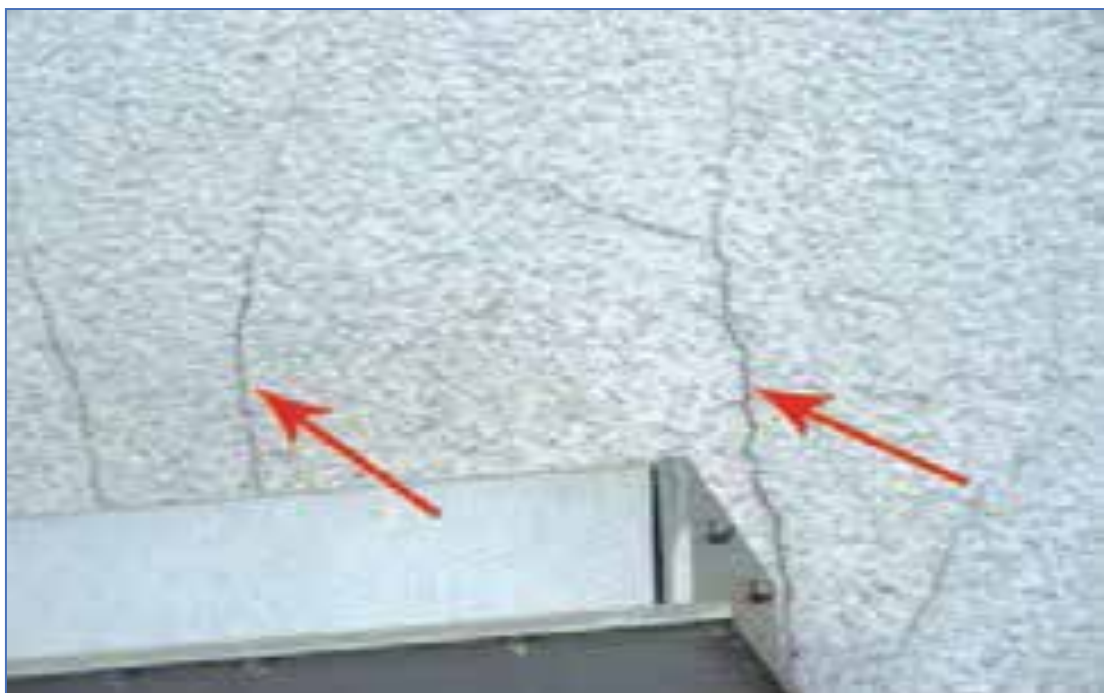
Слика 134 Пукотине на фасади настале као посљедица непостојања дијагоналне арматурне мрежице
